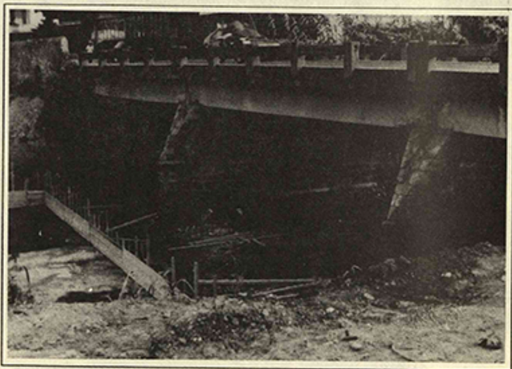
Νότια όψη της γέφυρας. Διακρίνονται τα 3 τόξα και οι πλοκοί με το cordone. Η νεότερη ταμεντένια κατασκευή αλλοιώνει σημαντικά την εμφάνιση του μνημείου.
